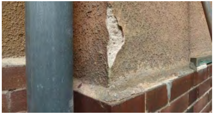
Abb. 398: Putzschäden im Spritzwasserbereich des überstehenden Sockels
