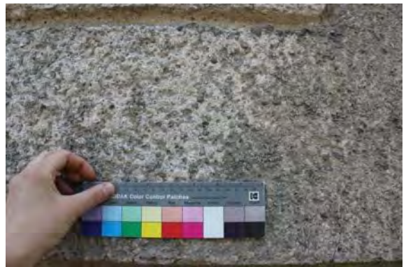
Abb. 110: Oberflächliches Absanden an der Villa Adlon (Objekt-Nr.: 2587).
