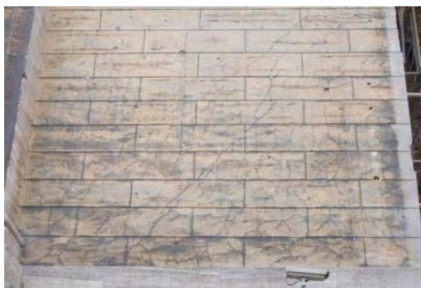
Abb. 494: Steinputz Nordfassade Mittelbau Nord, Craquelée
