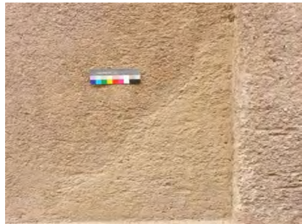
Abb. 474: Liebermann-Villa, Detailansicht mit Ausbesserung (2002) des Fassadenputzes
