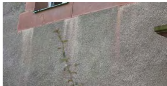
Abb. 117: Auswaschungen an der Johann-Peter-Hebel-Grundschule & Cäcilien-Grundschule (Objekt-Nr.: 4302).
