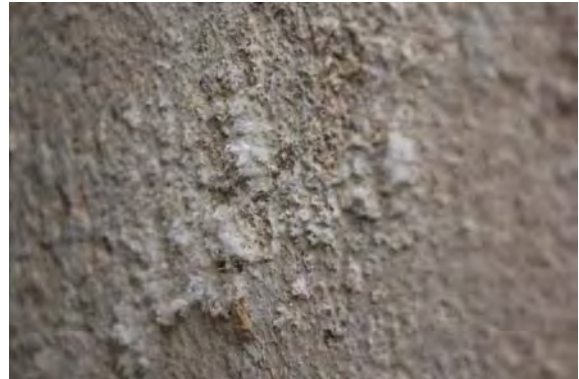
Abb. 95: Salzausblühungen an der Dorfkirche in Kroppen.
