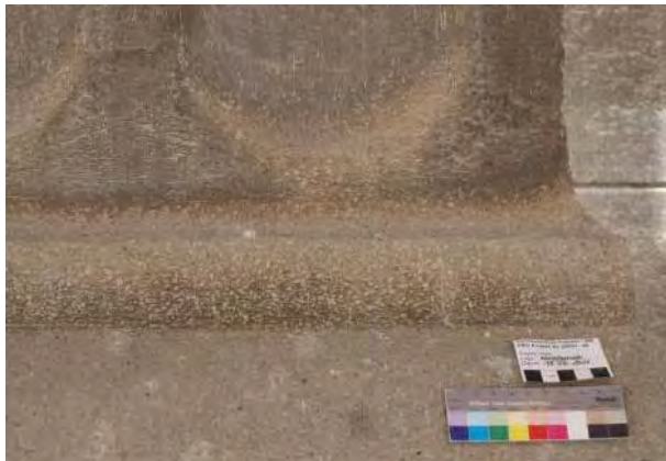
Abb. 501: Unterer Bereich der Kanneluren an der Pilasterbasis
