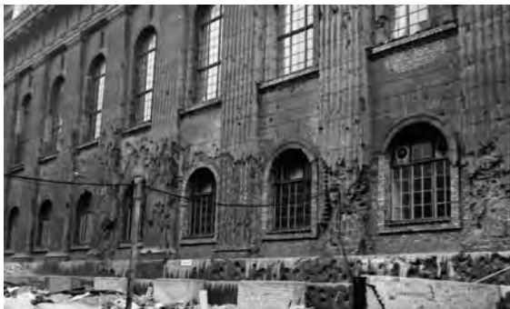
Abb. 130: Kriegsschäden am Pergamonmuseum (Objekt-Nr.: 3101). Historische Aufnahme.
