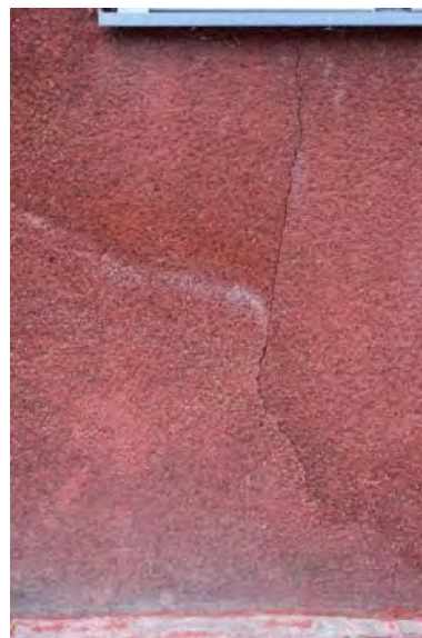
Abb. 123: Rissbildung, Onkel-Bräsig-Straße Nr.44 (Objekt-Nr.: 1200).
