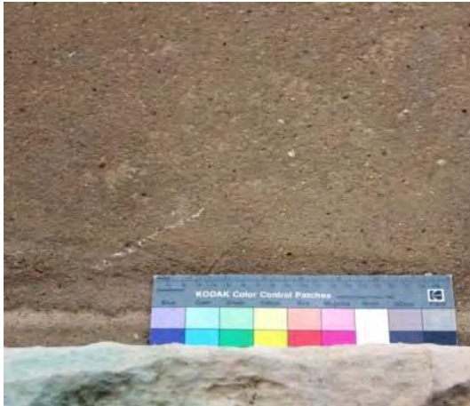
Abb. 56: verriebener Glattputz am Goethe-Gymnasium in Berlin. (Objekt-Nr.: 4320)
