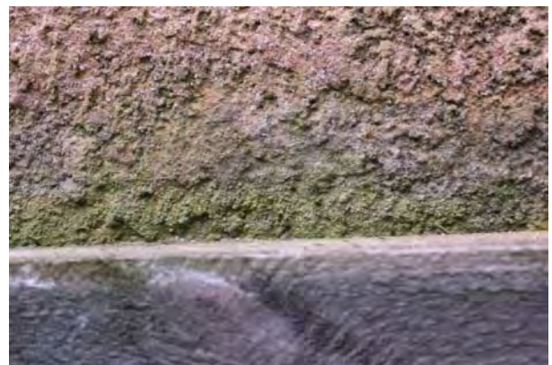
Abb. 400: Schadensbild mikrobieller Befall
