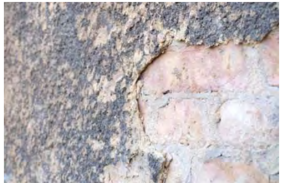
Abb. 129: Fehlstelle am Säuglingskrankenhaus in der Hansastraße (Objekt-Nr.: 4006).
