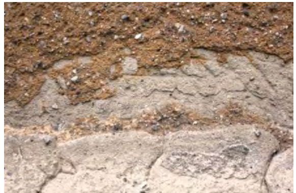
Abb. 111: Starkes Absanden an der Villa Amundsenstraße (Objekt-Nr.: 2588).
