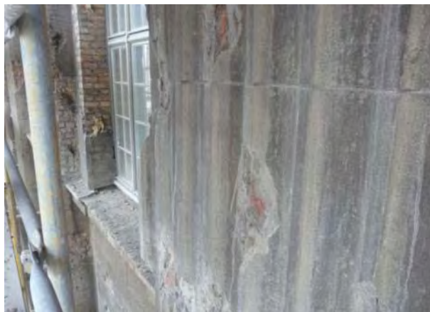
Abb. 493: Steinputz Nordfassade Mittelbau Nord, kriegsbedingte Substanzverluste
