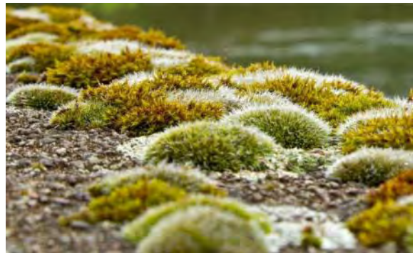
Abb. 100: Starker Moosbewuchs an feuchtigkeitsbelasteten Bereichen.
