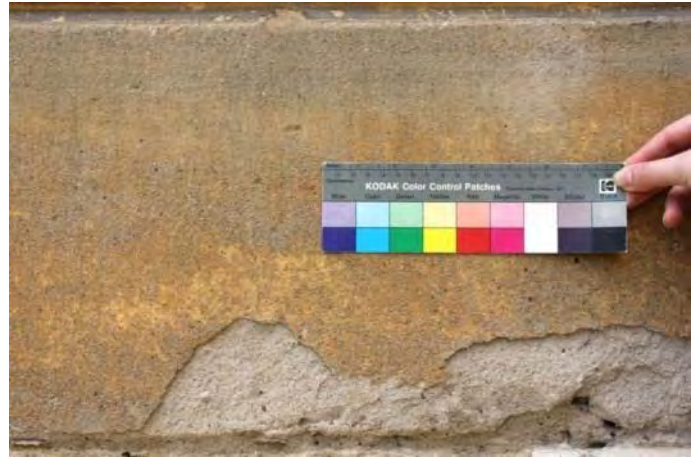
Abb. 57: verriebener Glattputz am Goethe-Gymnasium in Berlin. (Objekt-Nr.: 4320)
