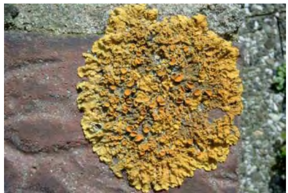
Abb. 99: Flechtenbewuchs an Ziegelmauerwerk.
