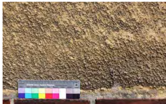
Abb. 90: Gipskrusten und Absanden am Wohnhaus Schöneiche (Objekt-Nr.: 2590).
