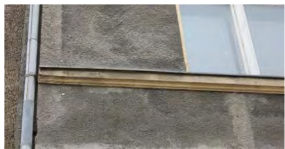
Abb. 118: defektes Wasserableitsystem am Wohnhaus Berliner Straße (Objekt-Nr.: 2206).
